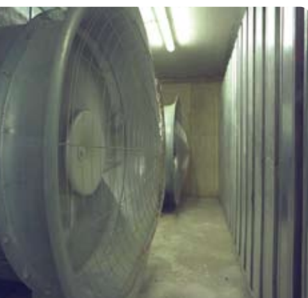
Aufstellung Axialventilatoren für Zu- und Abluft
